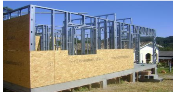
Figura 3. 18 - Estrutura LGSF revestida [W36]
