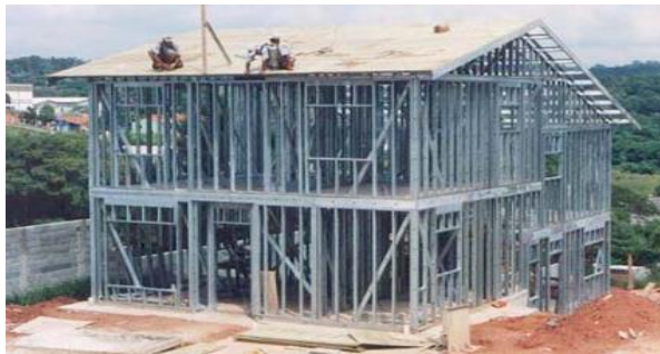
Figura 3. 17 - Habitação em estrutura LGSF [W35]
